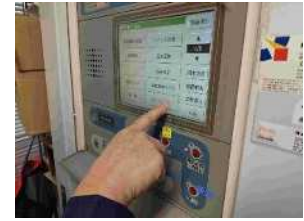
<消防設備保守点検>
