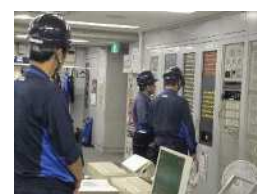
＜消防設備保守点検＞
